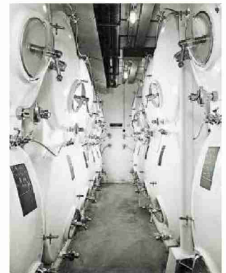
Die Tanks wurden mit individueller Kühlung ausgestattet.
